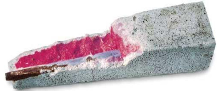
Tests de fenolftaleína y de cloruros para ver el estado del hormigón
