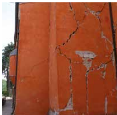
Fisuras a cortante
