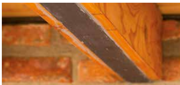
Refuerzo a flexión de vigas de madera mediante aplacado con CARBOPLATE SYSTEM
