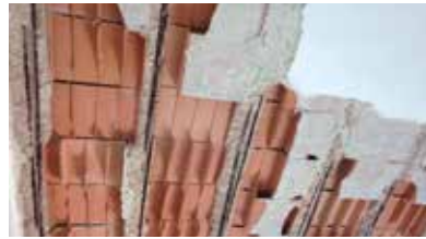
Desplome de forjado
