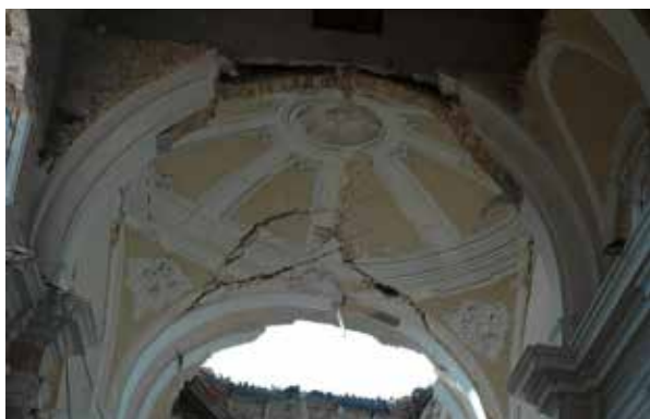
Colapso de bóvedas de albañilería
