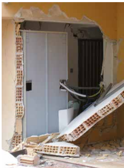
Vuelco de tabiquería interior
