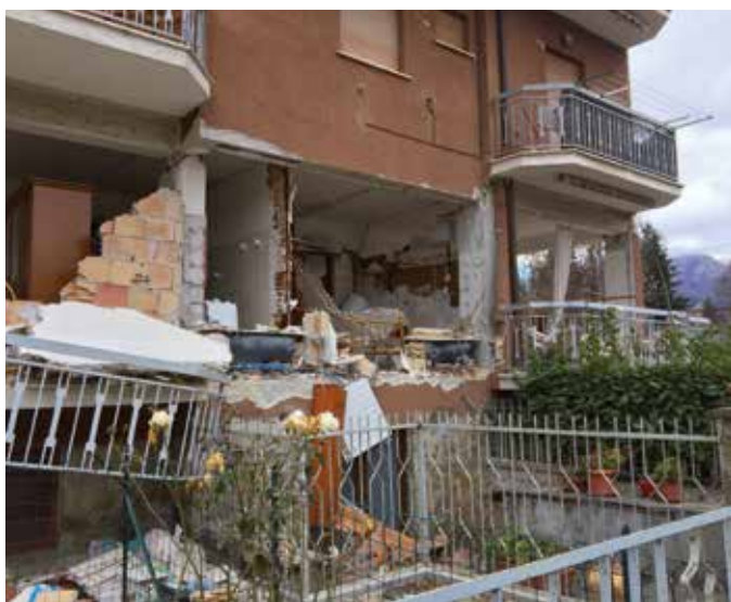
Colapso de cerramiento exterior
