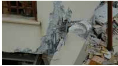
Colapso por planta débil
