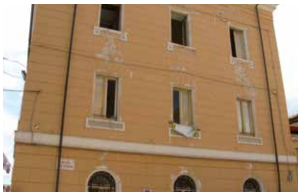
Fisuras a cortante de muros de cerramiento
