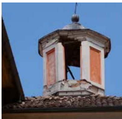
Daños en linterna
