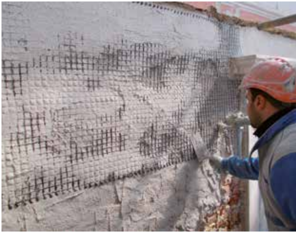
Aplicación del refuerzo de bajo espesor, para incrementar la resistencia a cortante y a tracción de muros de cerramiento
