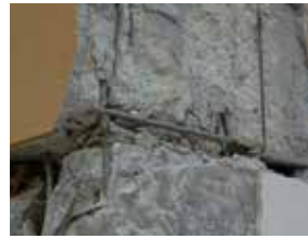
Defectos en las juntas de hormigonado
