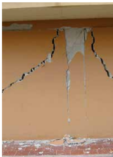
Rotura a cortante de cerramiento
