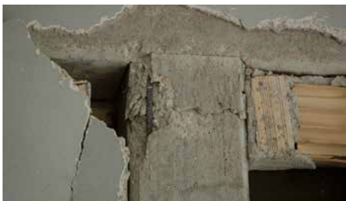
Interacción local entre cerramiento y rotura por cortante en el hormigón armado
