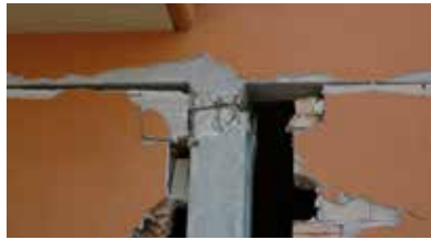
Rotura a cortante de pilar
