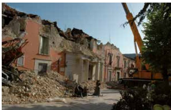
Muros con prestaciones mecánicas insuficientes
