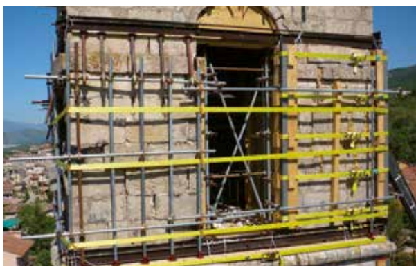
Daños en campanarios
