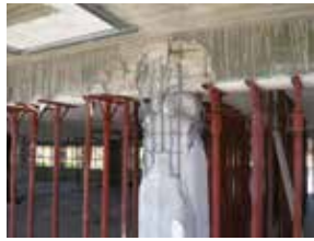
Defectos de construcción
