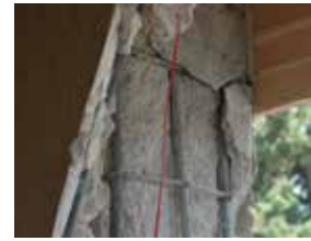
Inestabilidad de las barras de la armadura
